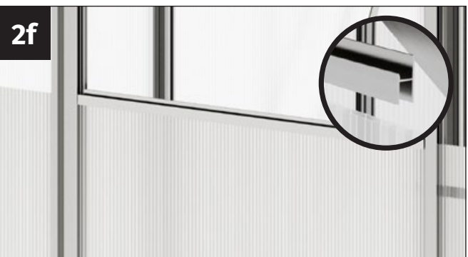
2f Plasser en H-profil på de tre dobbeltveggplatene på bakveggen. Se også det detaljerte bildet av hvordan du fester H-profilene!
