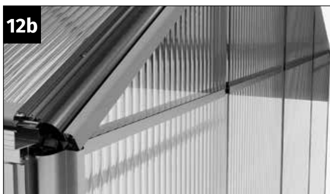
12b Coloque o clipe no perfil do telhado. Certifique-se de que este está bem encaixado em todo o comprimento.
